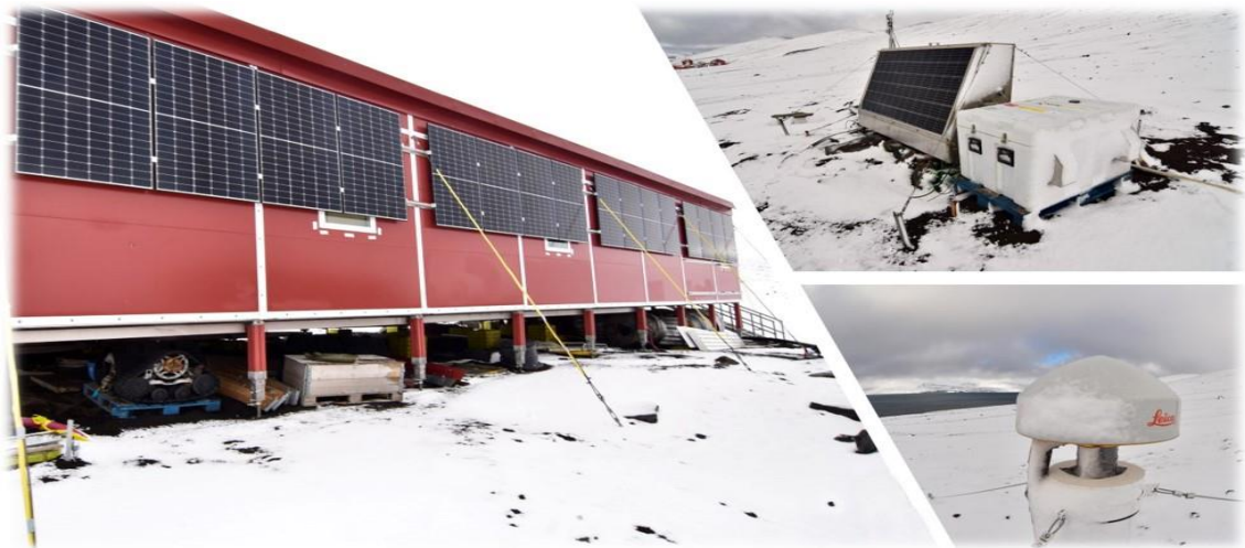
Figura 1: Izqda. paneles solares instalados en el módulo taller de la base. Sup. dcha. Caseta, Estación sísmica y pila de metanol. Inferior dcha. Estación GNSS.
