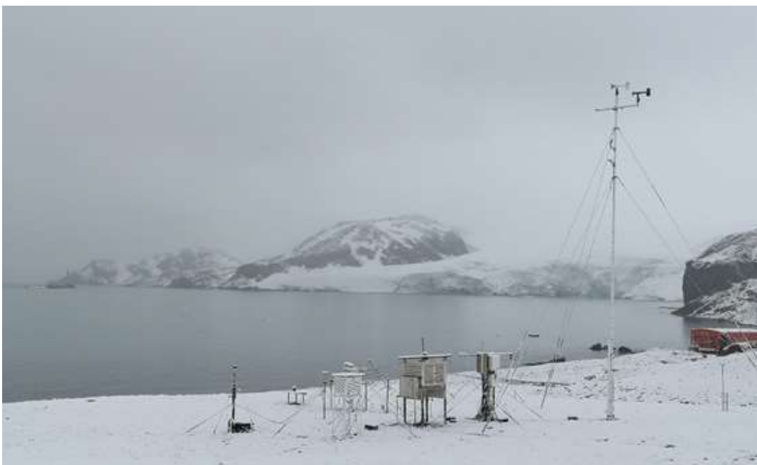
Figura 4: Infraestructura meteorológica en Base Juan Carlos I
